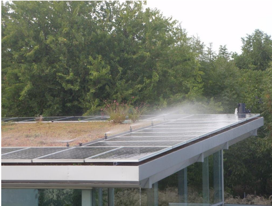
Figura 2-11: Impianto di raffrescamento superficiale dei pannelli solari FV in funzione.
