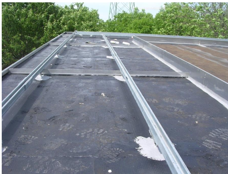
Figura 2-9: Ancoraggi e profili drenanti in acciaio zincato ed alluminio, posizionati sotto i pannelli fotovoltaici.
