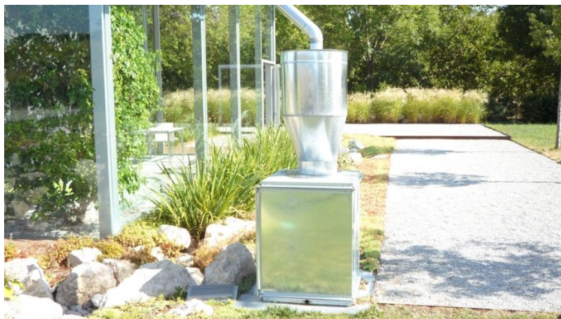
Figura 2-22: Sistema di raccolta e monitoraggio acqua di ritorno dal tetto: LEM
